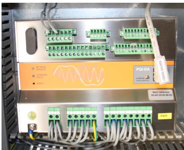
Abb. 2: Power-Quality-Messgerät im Projektgebiet Netz der Zukunft
