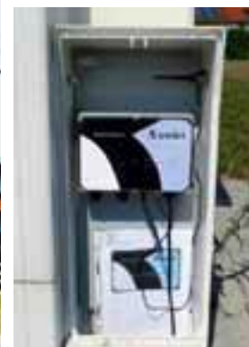
Der Segmentcontroller ist das Bindeglied zwischen Internetplattform und Leuchten.
