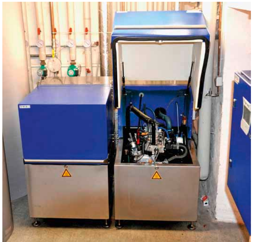
Zwei KWK-Module von EC-Power sorgen hier anteilig für die optimale Versorgung mit Strom und Wärme.
