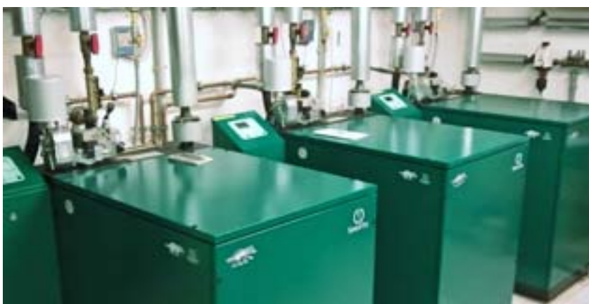
Die Mini-BHKW-Anlage erzeugt neben Strom auch Wärme.
