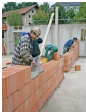
Tagsüber arbeiteten rüstige Rentner auf der Baustelle, abends und am Wochenende packten auch die Berufstätigen tatkräftig mit an.
